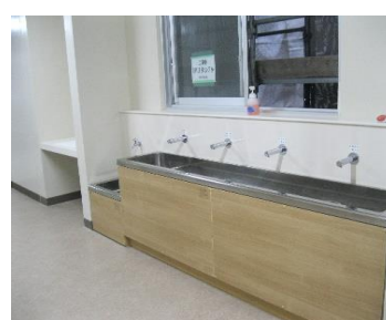
中央廊下の自動水栓水道
